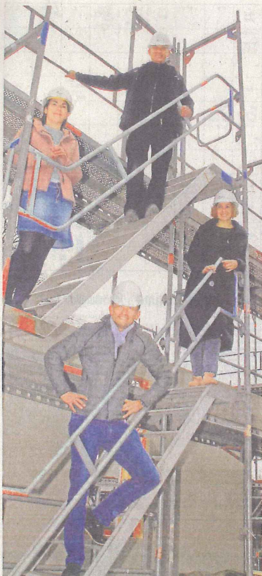
Zimmermeister Jens Boysen (v. ob.), Sophie Gläser, Leiterin der SVS-Tagespflege, Vorstandsassistentin Sandra Henschel und Jan Oelkers von der Suchtberatung auf der Baustelle am Völckers Park.
