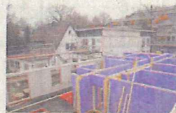
Der Blick vom Gerüst auf das Erdgeschoss und den Altbau: Das Gebäude liegt direkt hinter dem Rathaus.
